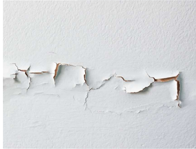
Yalıtımsız Duvardaki Kabarma
